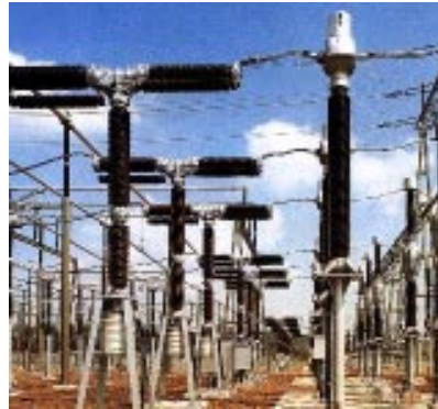
ABB SF6 ELF Breaker
